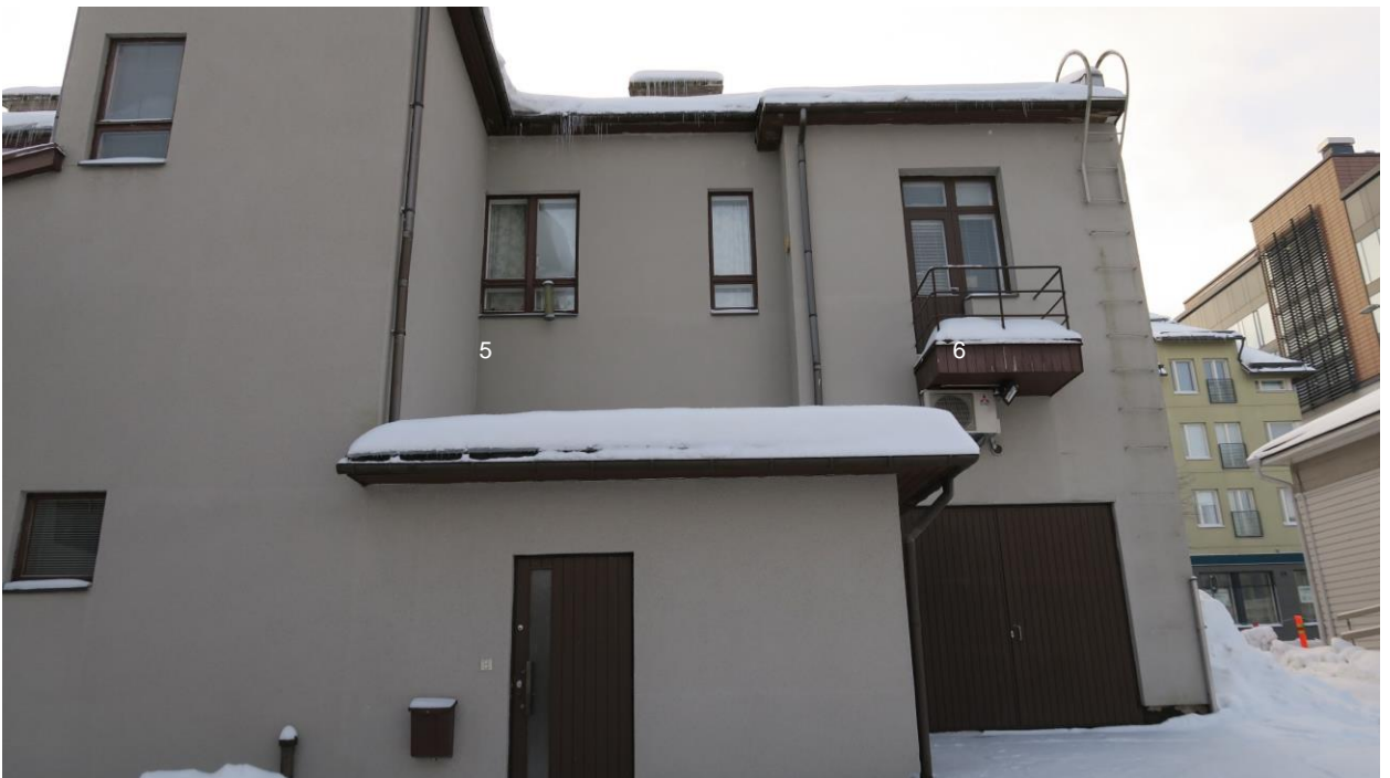
Kuva 130. Sisäpihalta etelään, pohjoissivu. Alaosan vanhan porttikongin paikalla on autotallin pariovet. Pihajulkisivun rappaus on sileämpi ja sävy eri kuin muualla julkisivuilla.
